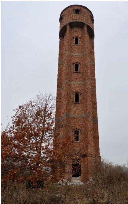
FF.1 Vaizdas iš rytinės pusės. Bokštas 6 tarpinių (aukštų), viršutiniame tarpnyje – vandens rezervuaro vieta.
