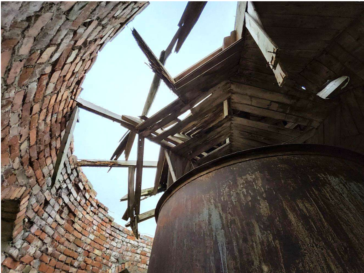
FF. 24 Stogas gegninės konstrukcijos, kūgio formos. Šiuo metu įlūžęs, labai blogos būklės.
