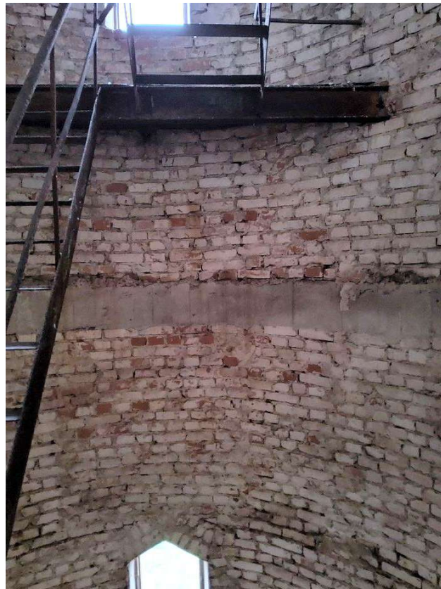
FF. 17 Bokšto mūras stiprintas betoniniais armuotais žiedais tarp antro ir trečio, trečio ir ketvirto, ketvirto ir penkto tarpinių.
