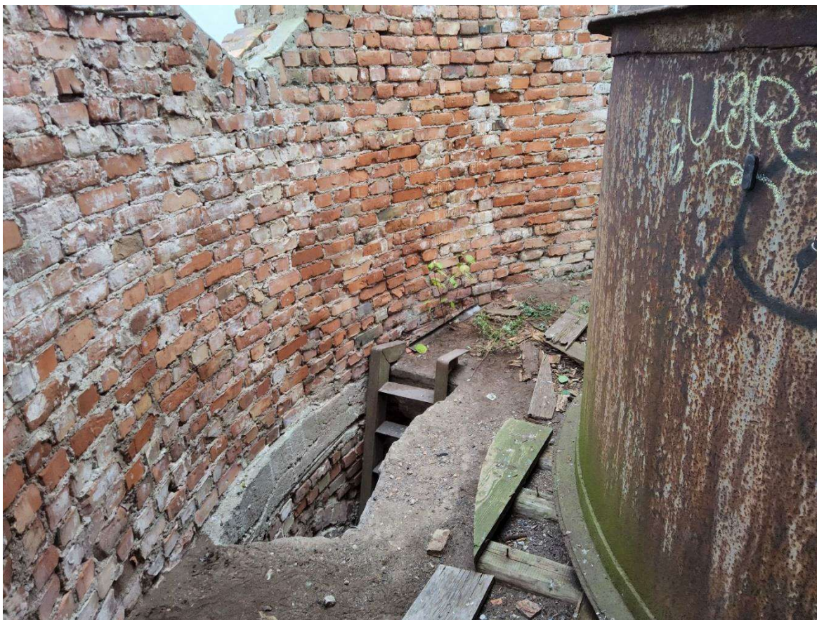
FF. 20 Vandens rezervuaro patalpa. Į ją patenkama metalinėmis kopėčiomis pro angą betoninėje monolitinėje perdangoje.
