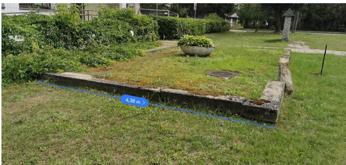
4 pav. Nusidėvėjusi šiluminės kameros atraminė sienelė
