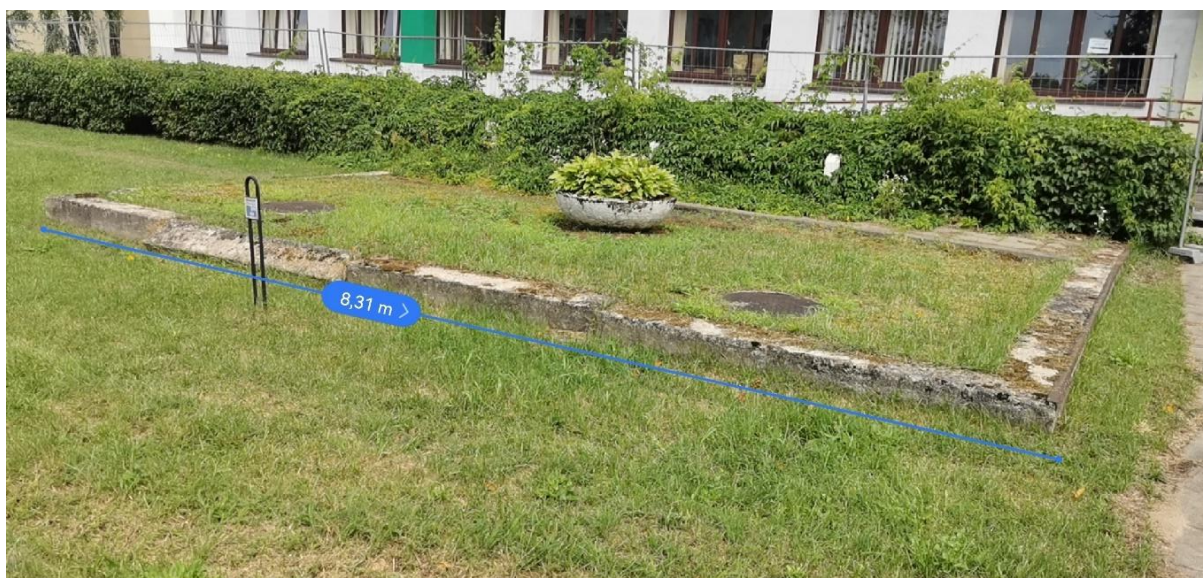
5 pav. Nusidėvėjusi šiluminės kameros atraminė sienelė
