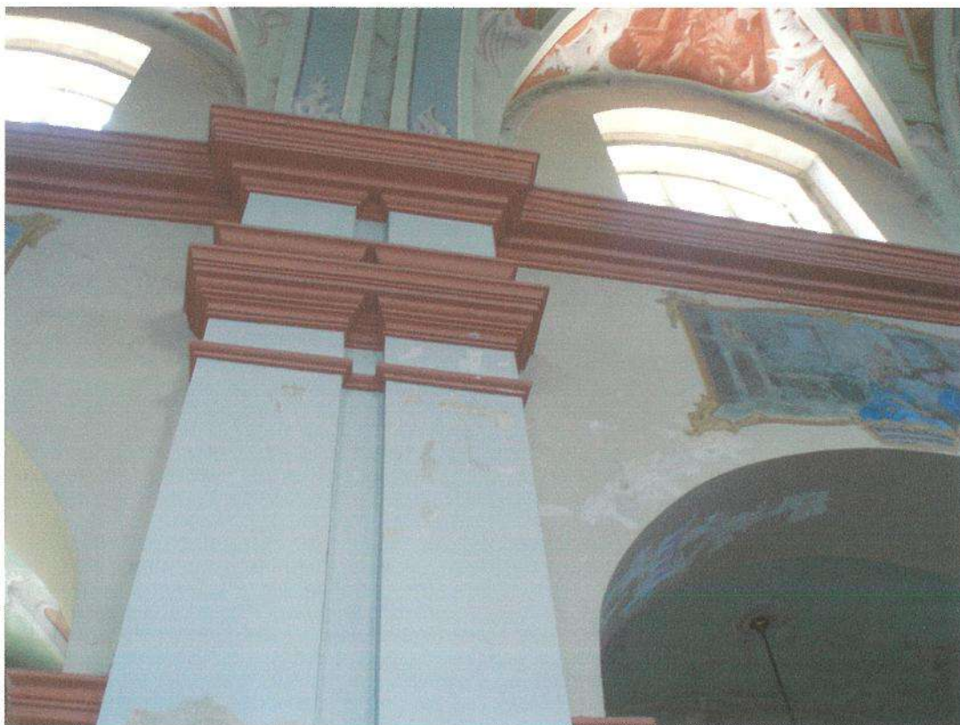
F10. Centrinės navos piliastrai. Zondažuose z.248-251 virš arkos atidengti kelių laikotarpių arkos tapybiniai apvadai.
