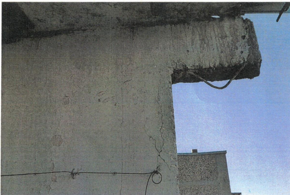
Pav. 5. Vertikalios laikančiosios plokštės viršaus pažaidų vaizdas
