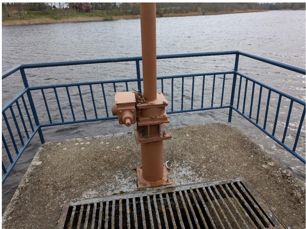
Uždorių pakėlimo mechanizmas, tarnybinio tiltelio turėklai
