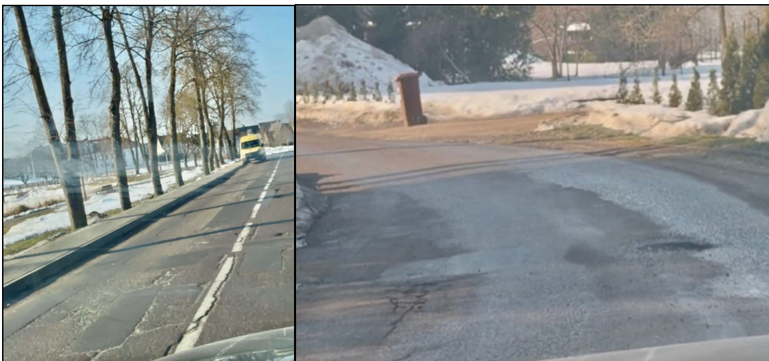
2 pav. Šaltinio gatvės asfalto dangos būklė
