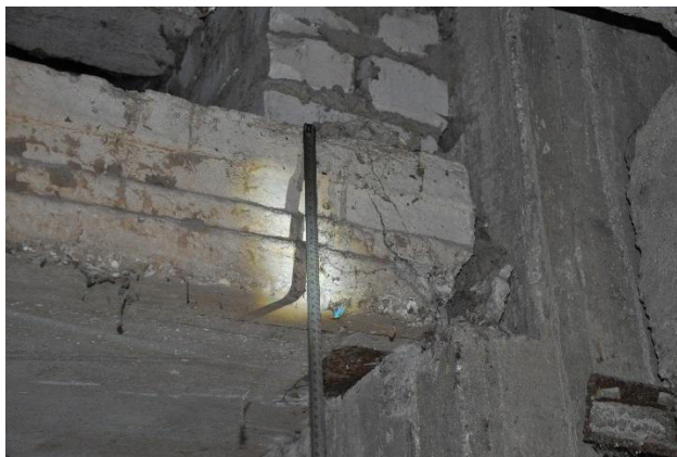
2.7 pav. Tribūnų perdangos plokščių pažaidų vaizdai
