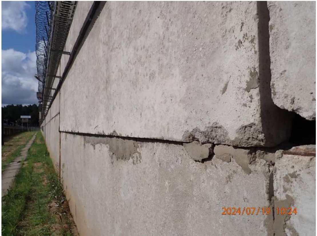
Nuotrauka Nr. 3. Nuskilę plokščių kampai (apatiniai plokščių kampai nėra pritvirtinti prie stulpų), pasislinkusios plokštės, ištrupėjęs cementinis siūlių užpildas
