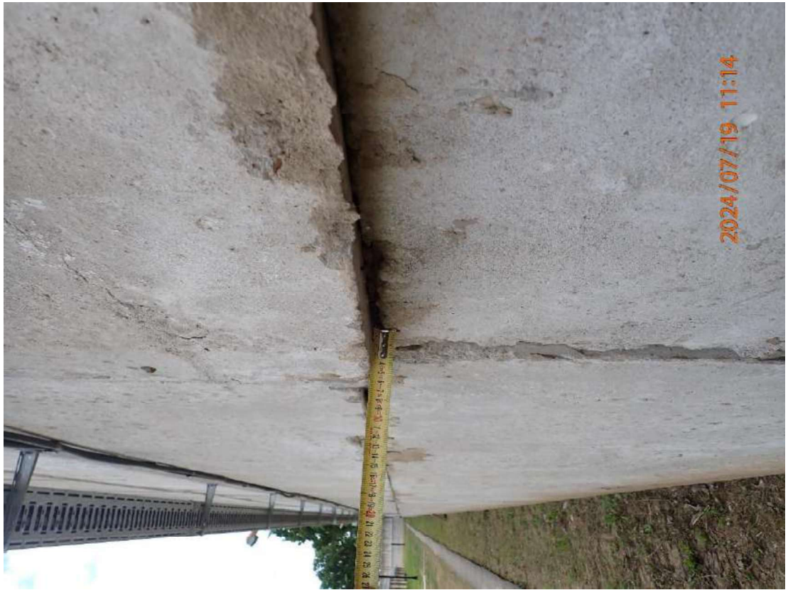
Nuotrauka Nr. 9. Tvoros plokščių poslinkiai „iš tvoros plokštumos“ viršija 5cm, ištrupėjęs cementinis siūlių užpildas
