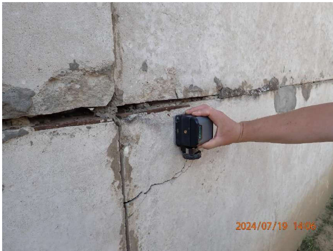
Nuotrauka Nr. 21. Plokščių armavimo tikrinimas iš vidinės pusės (matosi korozijos pažeistos įdėtinės detalės, plokštės įtvirtinimo taškas ties įdėtinėmis detalėmis nulūžęs (avarinė būklė))
