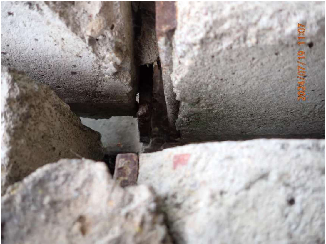
Nuotrauka Nr. 13. Plokščių montavimo kokybės trukumai (plokštės sumontuotos skirtingame aukštyje, prasislinkusios vertikalios siūlės
