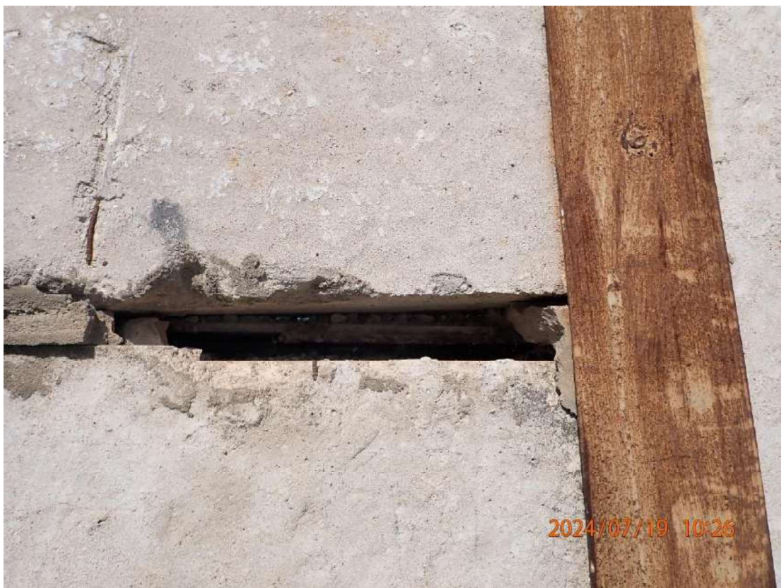
Nuotrauka Nr. 4. Ties deformacine siūle ištrupėjęs cementinis siūlės užpildas
