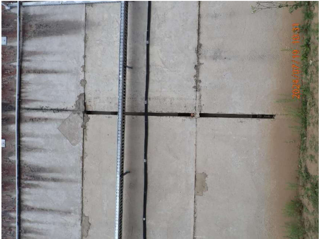
Nuotrauka Nr. 5. Plyšiai sienoje ties deformacine siūle (siūlės neturi būti tuščios, bet turi būti užpildytos nepermatomu elastiniu užpildu)
