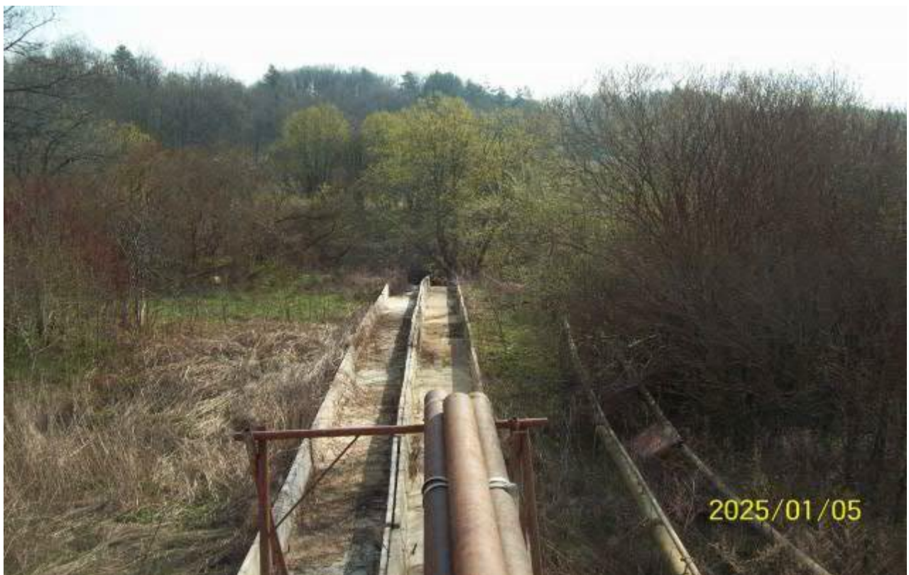
25 pav. Iš baseino įrengti latakai ir vamzdymo linijos vandens nuvedimui į Minijos upę.
