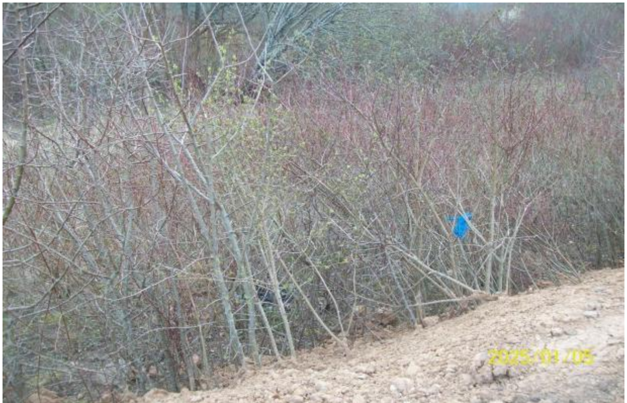
17 pav. Pylimo šlaitas apleistas ištisai auga krūmai.
