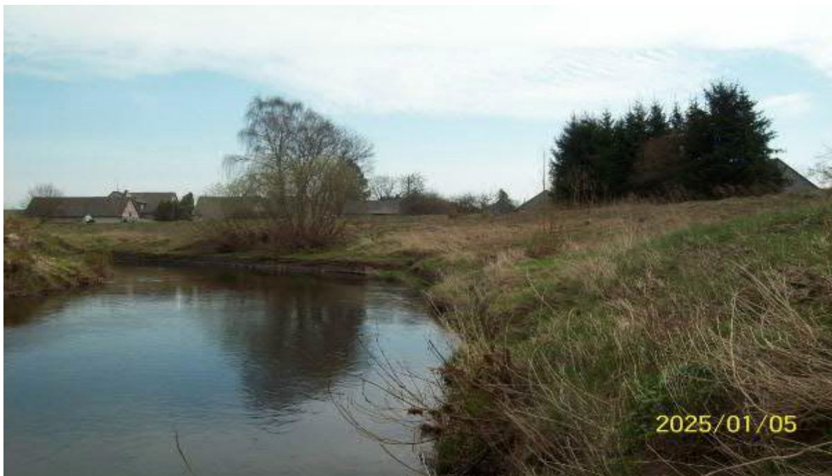
9 pav. Upės vagos posūkyje dešiniajame krante įrengta sienutė, paveikta vandens tėkmės, šalčio ir ledų dinaminių apkrovų.
