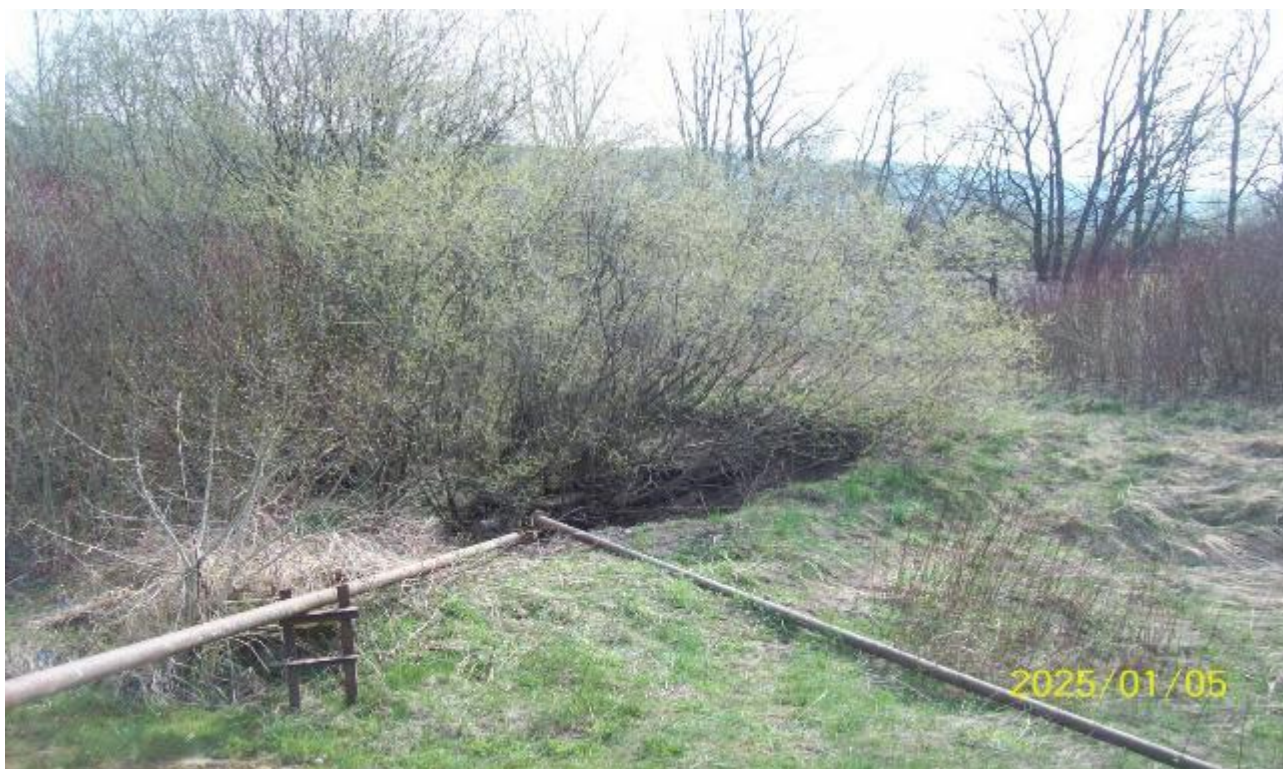
26 pav. Ardomas Minijos griovos šlaitas, nesustiprinta vandens ištekėjimo dalis.
