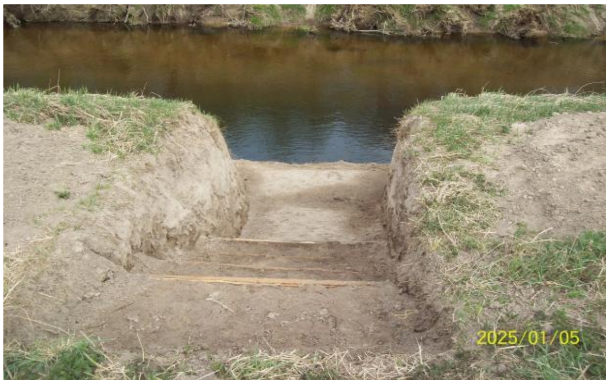
8 pav. Minijos upės krante savavališkai įrengti laiptai su terasa prie vandens. Potvynio metu upės šlaitas bus išplautas.
