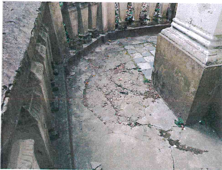
15. Cementinis užtepas koplyčios perimetru sutrūkinėjęs ir ištrūpėjęs.
