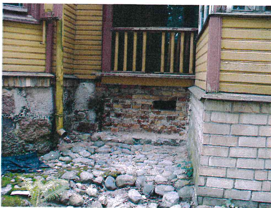
4. Sovietmečio laikotarpio keraminių plytų mūras pažeistas erozijos.
