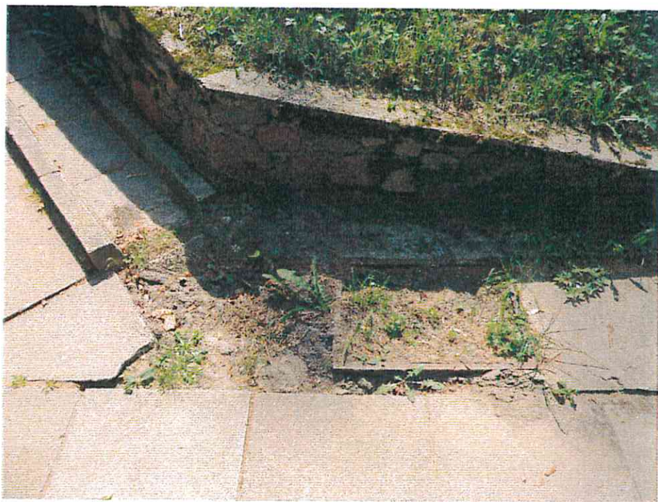
19. Kritulių surinkimo šuliniai nefunkcionuoja, užsikišę žemėmis.
