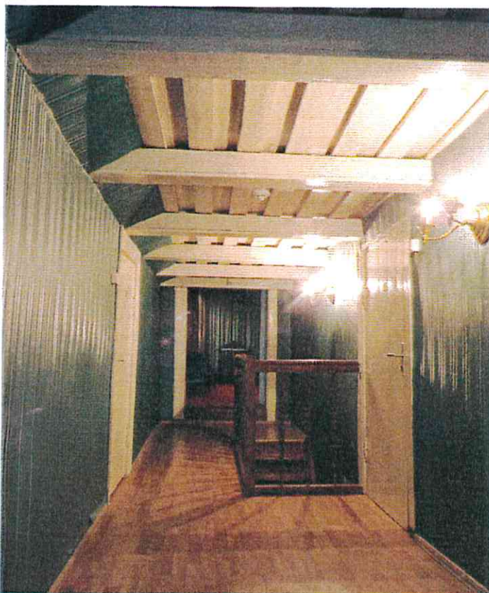
9. Mansardos lubose įrengtas dvigubas lentų paklotas su įmitacinėmis sijom.
