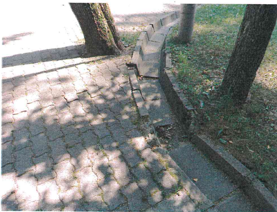
20. Kritulių nuvedimo latakai pasėdę, betonas ištrūpėjęs.
