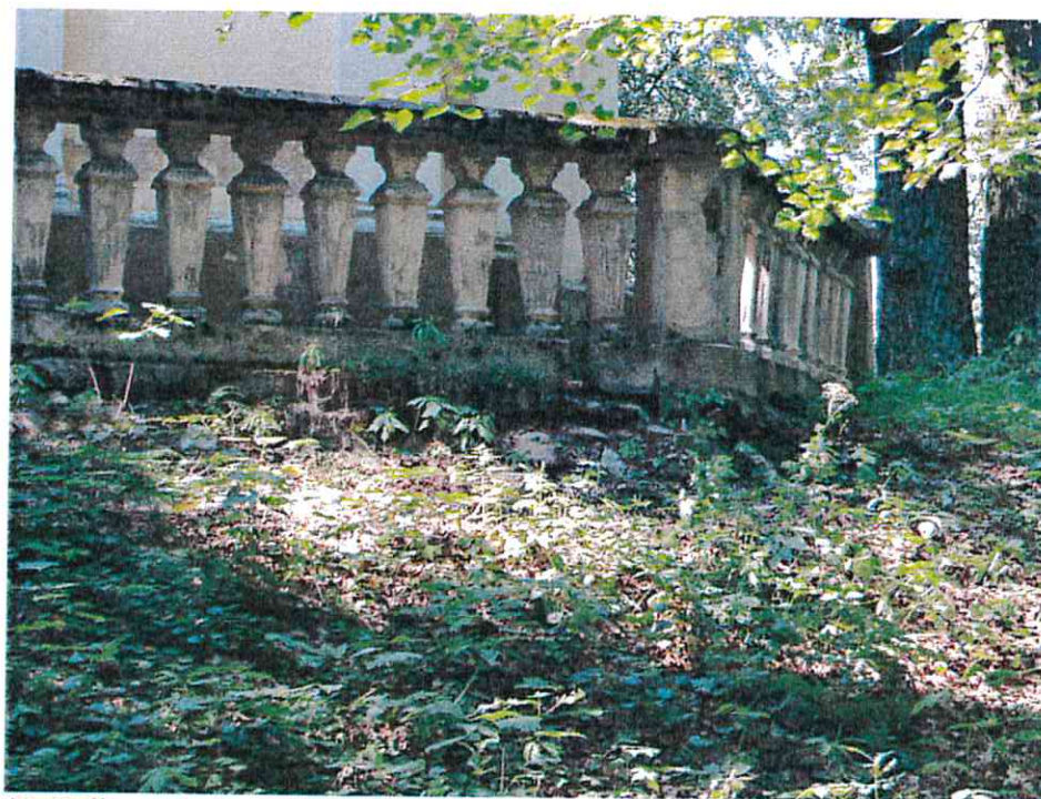
13. Baliustradų betonas sutrūkinėjęs ir vietomis nukritęs.
