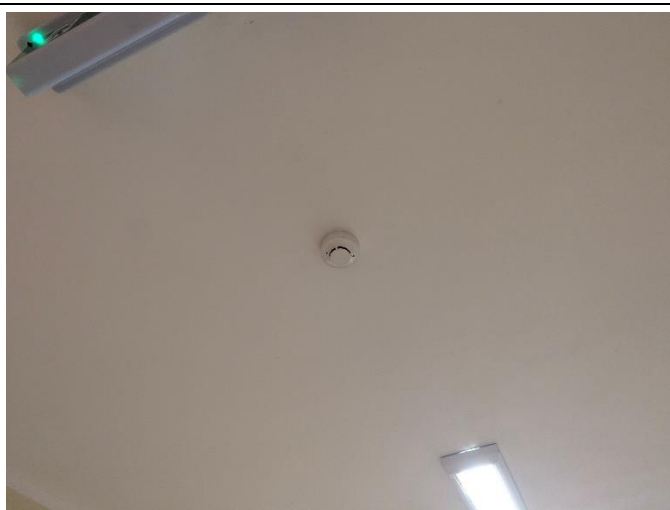
25 pav. Dūmų signalizacija.
