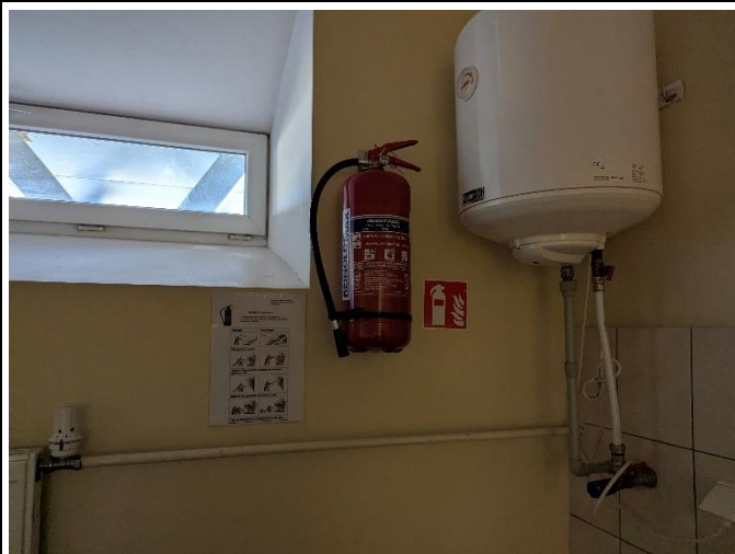
24 pav. Gesintuvas rūšio patalpose.
