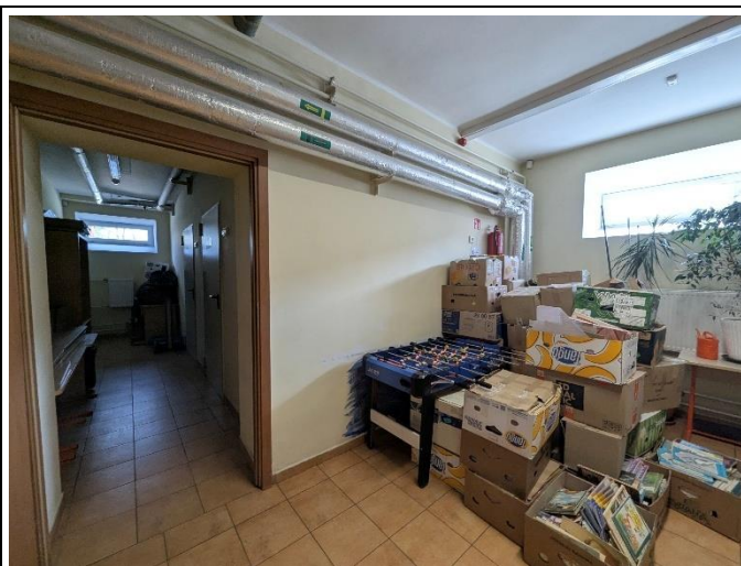
15 pav. Langai rūsio patalpose. Matoma šildymo įranga ties langu.
