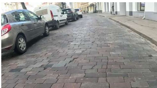
a) dangos nusėdimas su trinkelų dangos trūkiais
