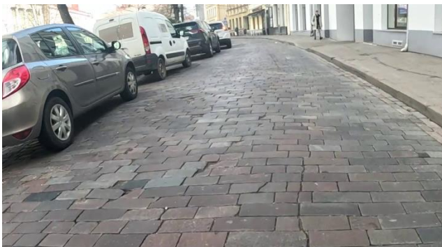
a) dangos nusėdimas su trinkelų dangos trūkiais
