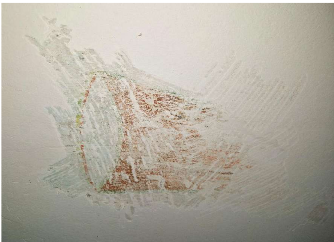
Patalpa 1-11. Tyrinėjama lubų zona Nr. 4. Neblogai išlikusi taurė, tačiau po ja jau motyvas sunykęs.
