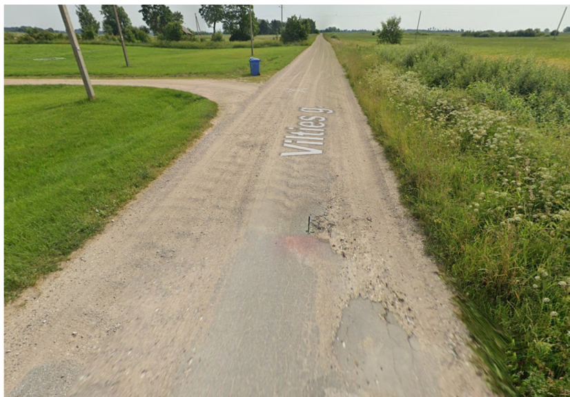
2 pav. Dangos būklė nuo 0,575 km iki 0,598 km
