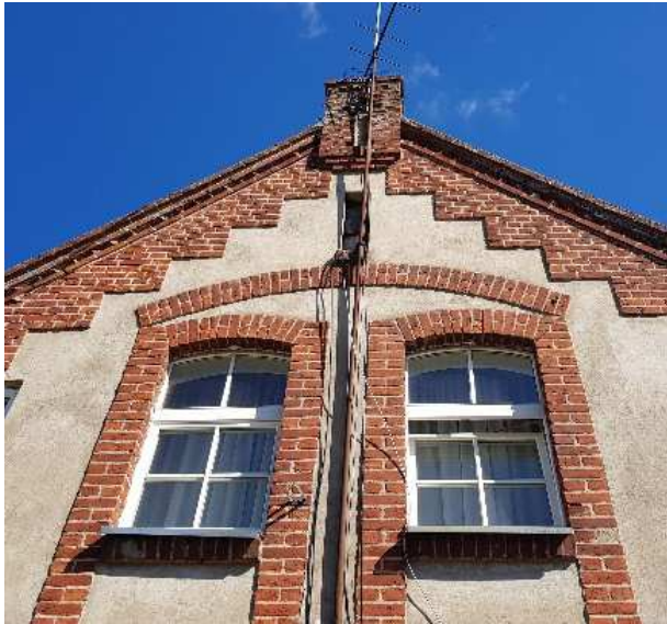
7 Pav. Pietinės pusės tinkuota fasado dalis Fasadų tinkuota dalis aprūpėjusi, tinkas atšokęs.
