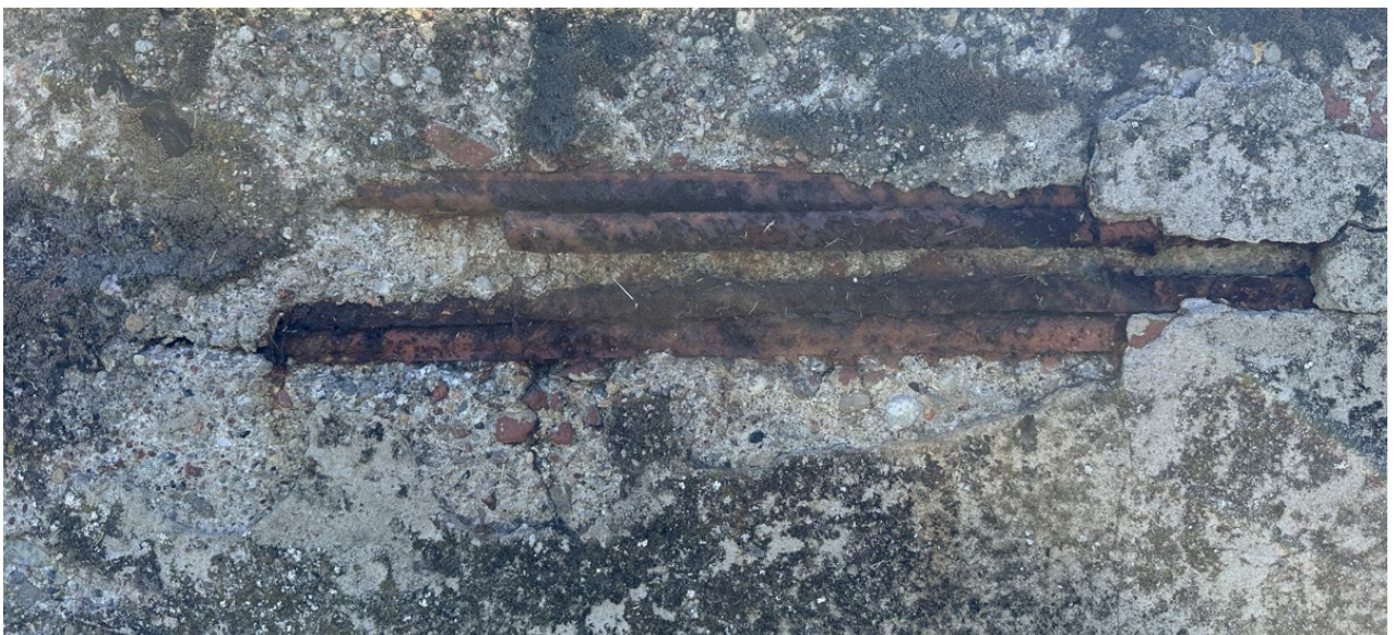
Pav. 7.4-2 Korozijos pažeista išorinė valymo įrengimo armatūra
