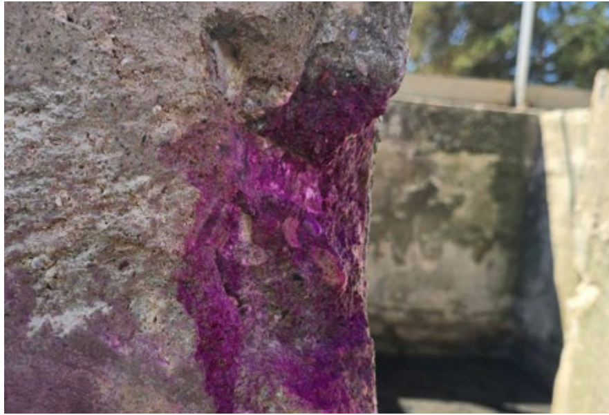
Pav. 7.6-2 Karbonizacijos proceso pažeistas betono paviršius
