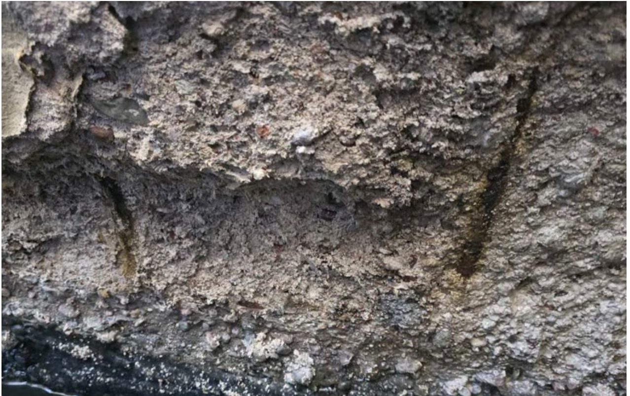
Pav. 7.4 Korozijos pažeista latako vidinės dalies armatūra
