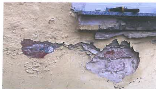
F-35. ŠV fasado I a. sienos plokštumos dažų atodanga. Zondažo Z-40 situacija.
