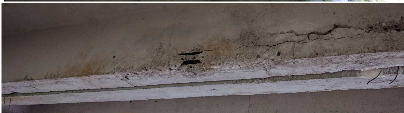
11 pav. Gelžbetoninės sijos supleišėjusios, atšokęs apsauginis betono sluoksnis, matoma koroduojanti armatūra
