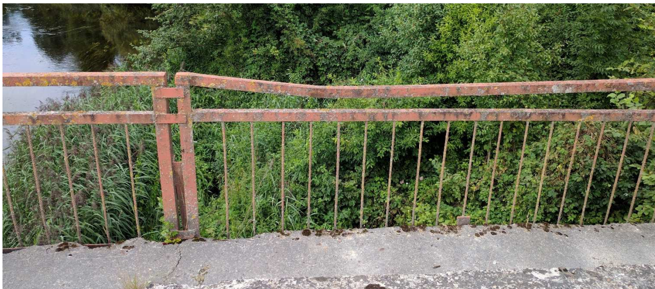
8 pav. Turėklai susideformavę, aprūdiję
