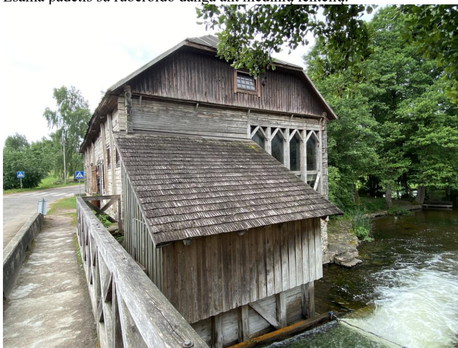
Esama padėtis. Turbinos patalpos stogas dengtas lentelėmis.
