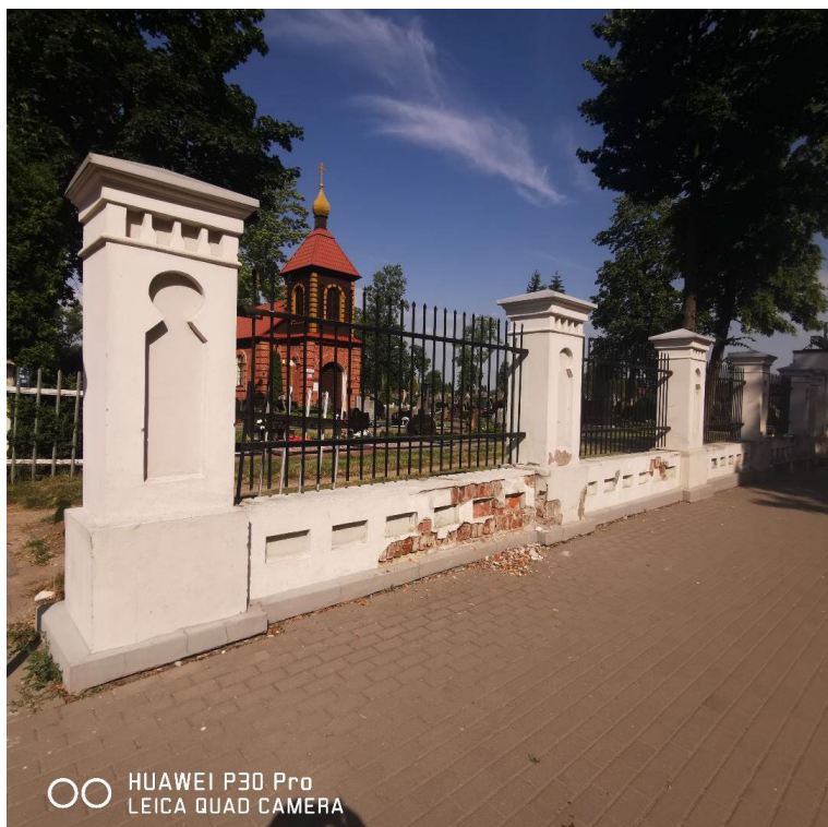
2022m. foto Pietinė tvoros dalis. Betoninio cokolio būklė patenkinama, mūras pažeistas kapiliarinės drėgmės.
