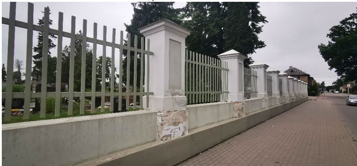
Foto 2022m. Šiaurinė tvoros dalis. Betoninis cokolis patenkinamos būklės, stulpų mūras pažeistas kapiliarinės drėgmės
