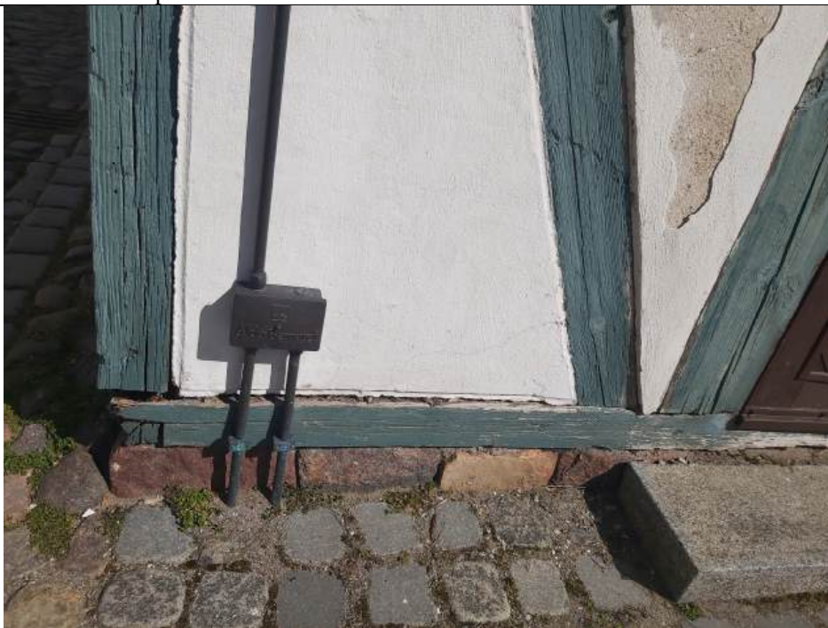
FF 04. Priestato PV fasado būklės ties cokoliu fotofiksacija
