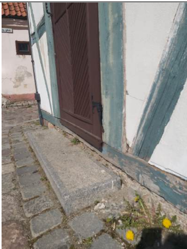
FF 07. Priestato PV fasado būklės ties cokoliu fotofiksacija
