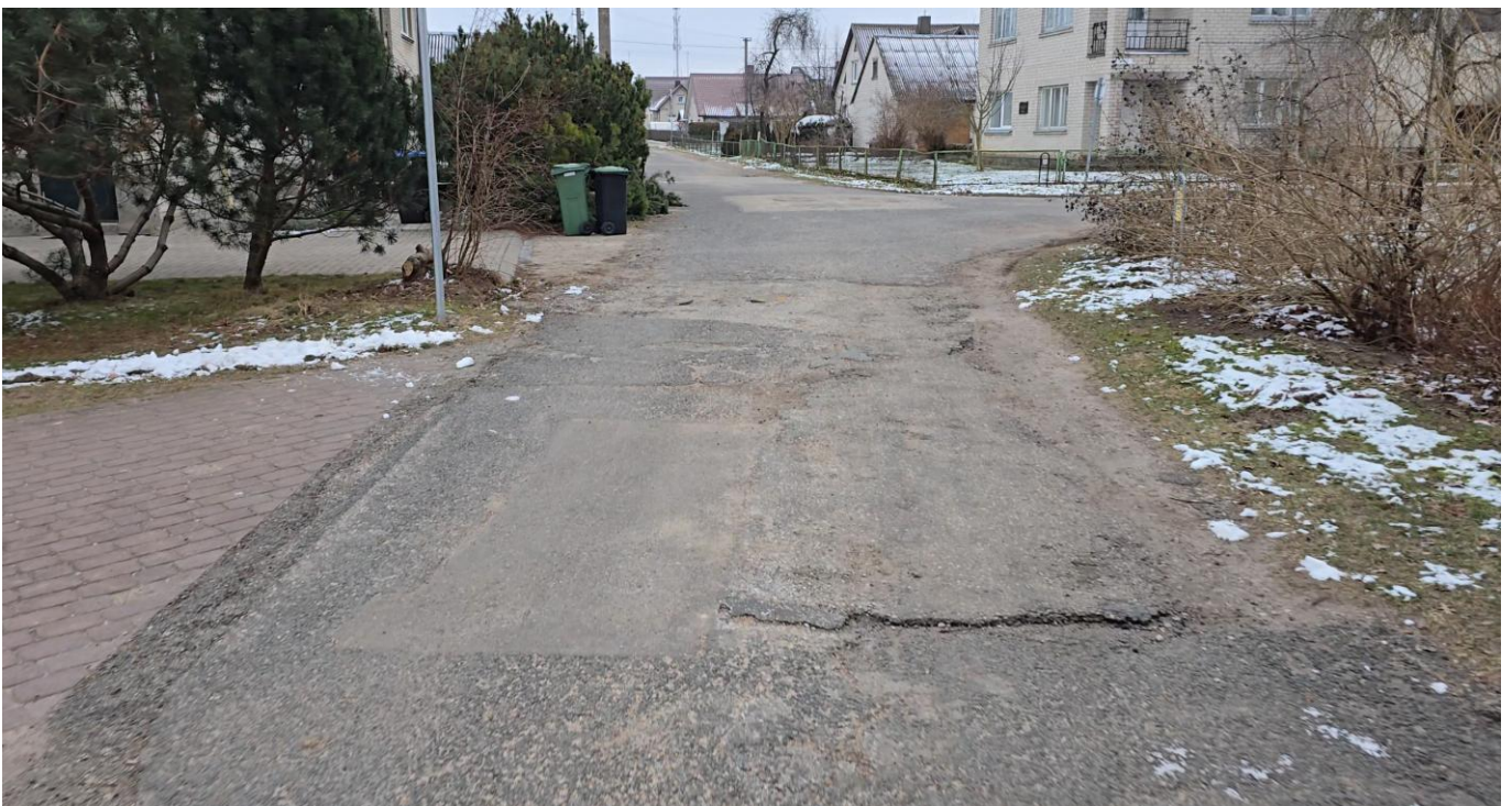
6 pav. Esama važiuojamosios dalies būklė Pavasario gatvėje
