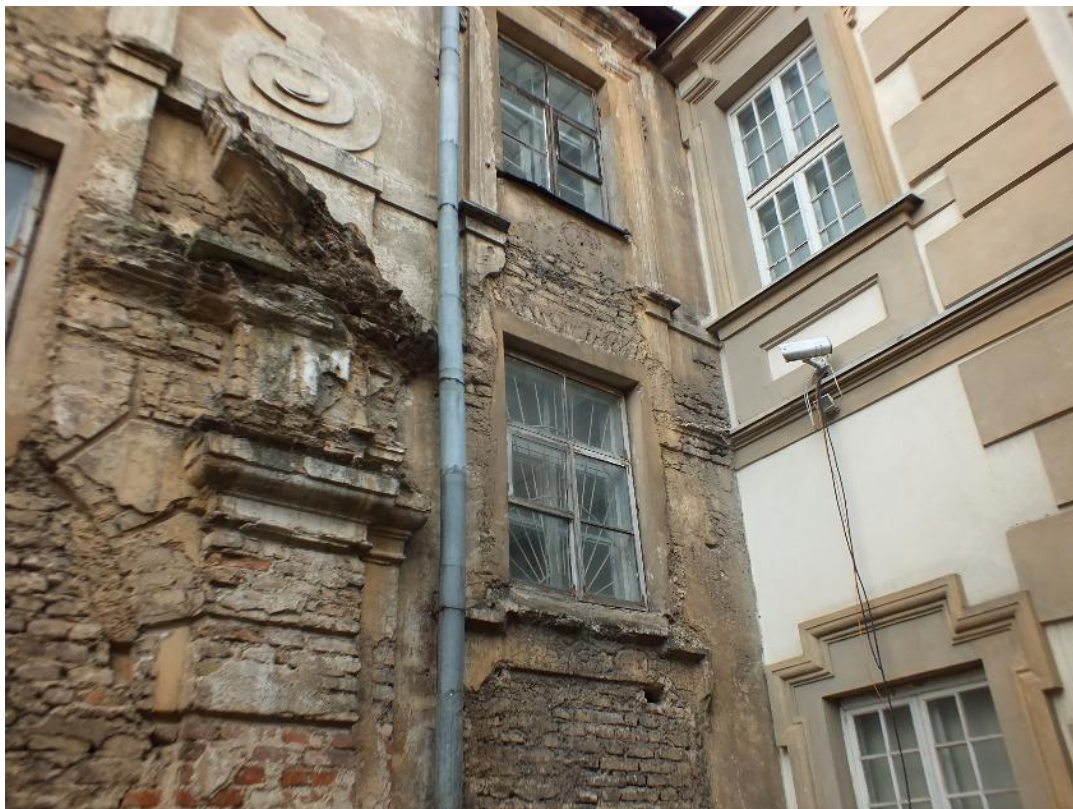
7 pav. Rytinio fasado mūro pažeidimai.
