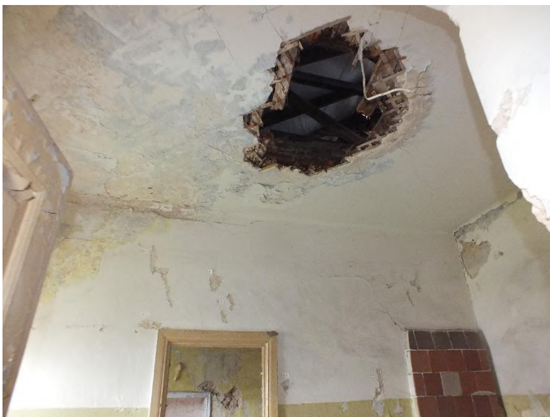
10 pav. Antro aukšto perdangos pažeidimai.
