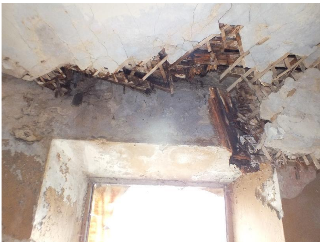
12 pav. Priestato trečio aukšto perdangos pažeidimai.
