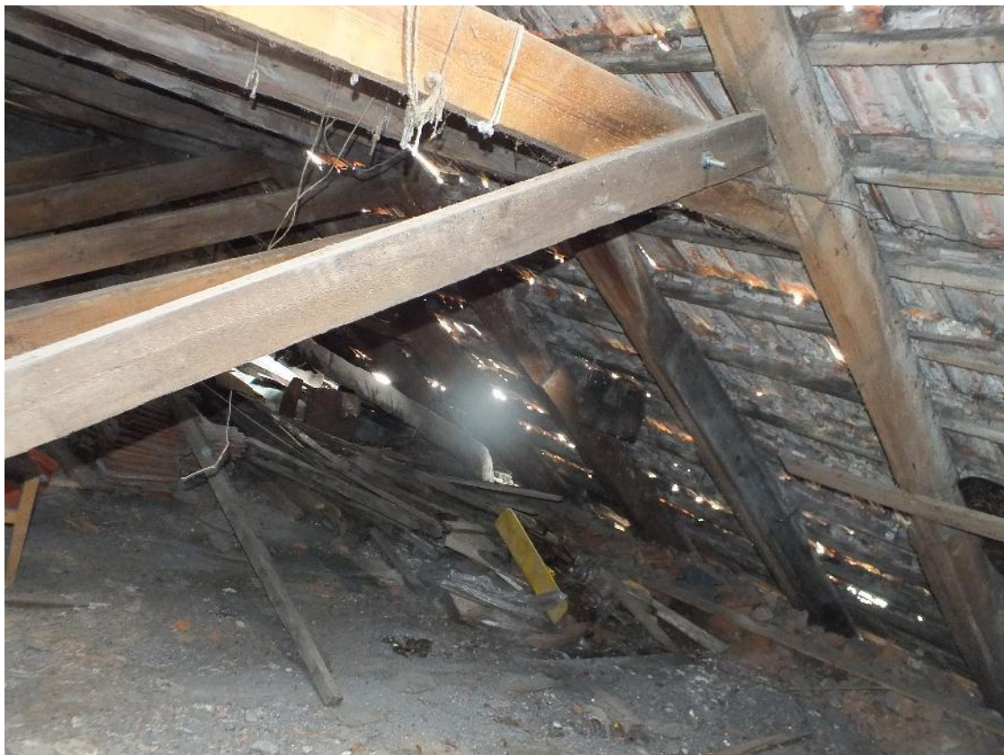
13 pav. Priestato rytinės dalies stogo konstrukcijos.
