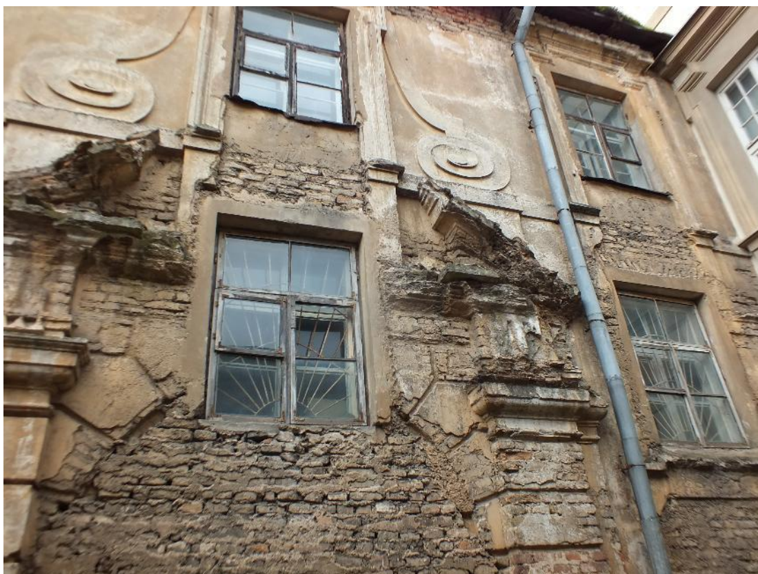
8 pav. Rytinio fasado šiaurinės dalies mūro pažeidimai.
