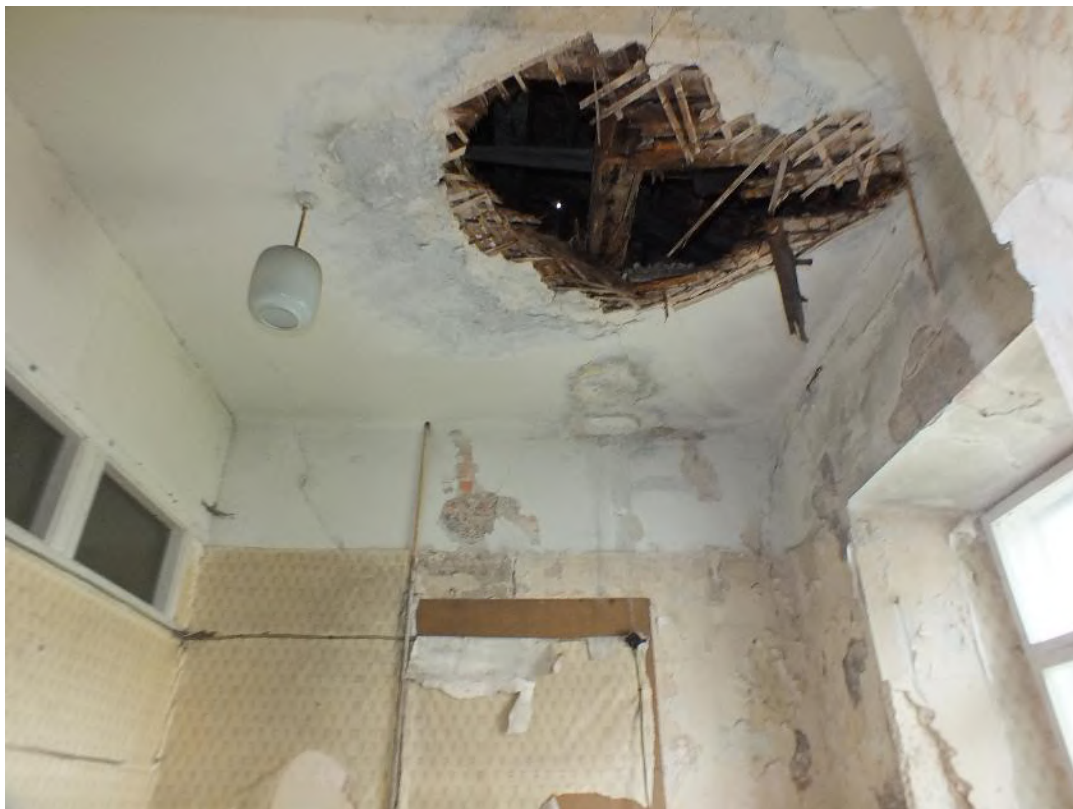
11 pav. Trečio aukšto perdangos pažeidima.
