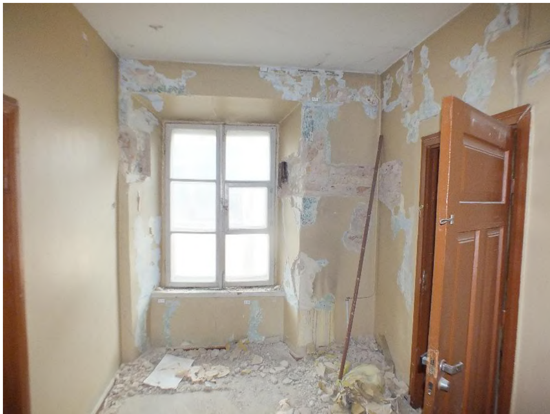
19 pav. Pastato vidaus sienų pažeidimai III aukšte.
