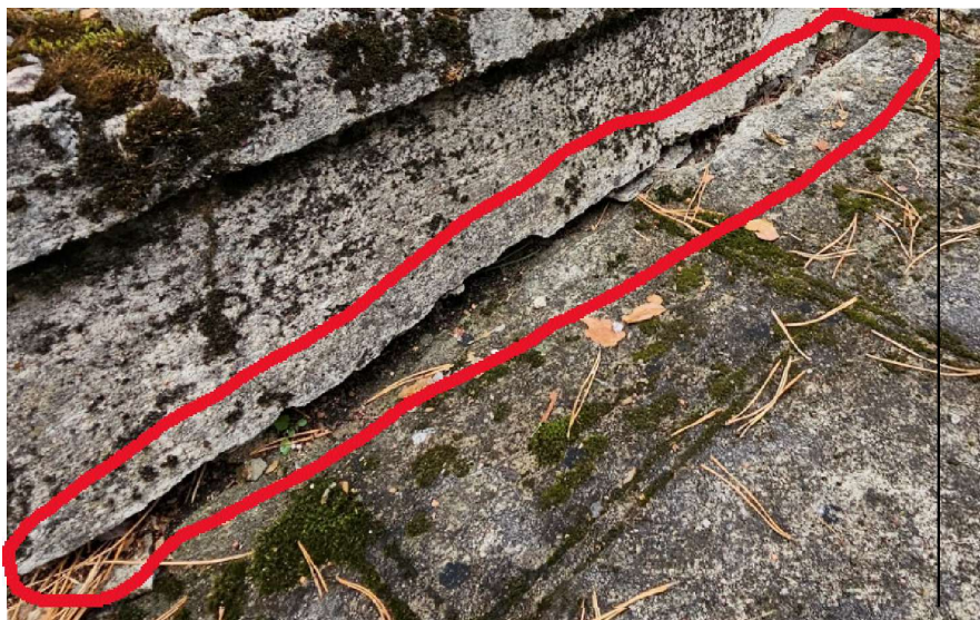
9. Tarp tvorelės ir grindinio eina ištisinis skilimas, yra tinko netekčių.
