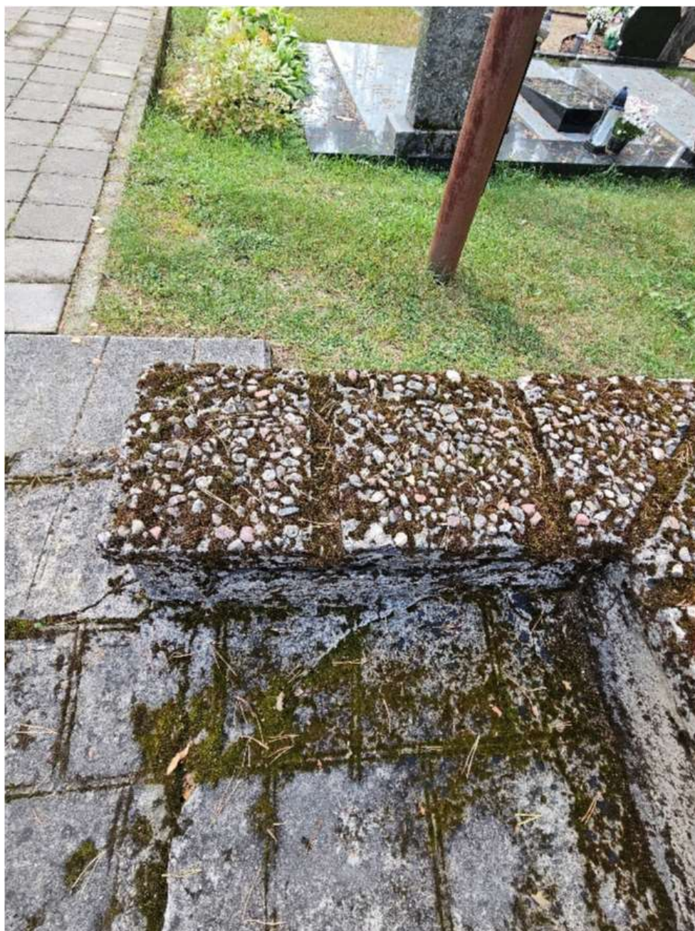
12. Paminklo tvorelės viršaus dekoratyviniai akmenukai išbirėję, visa tvorelė padengta purvu ir pažeista biologine tarša.
